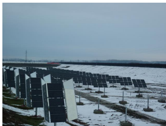
Parque em Itália com sistemas WS Energia (fonte: ISCAT)
